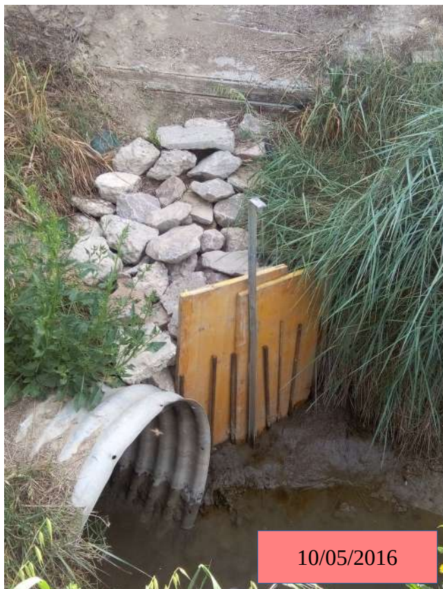
Foto n 9-Canale lato Ovest il 10/05/2016 (la perdita è stata tamponata)
