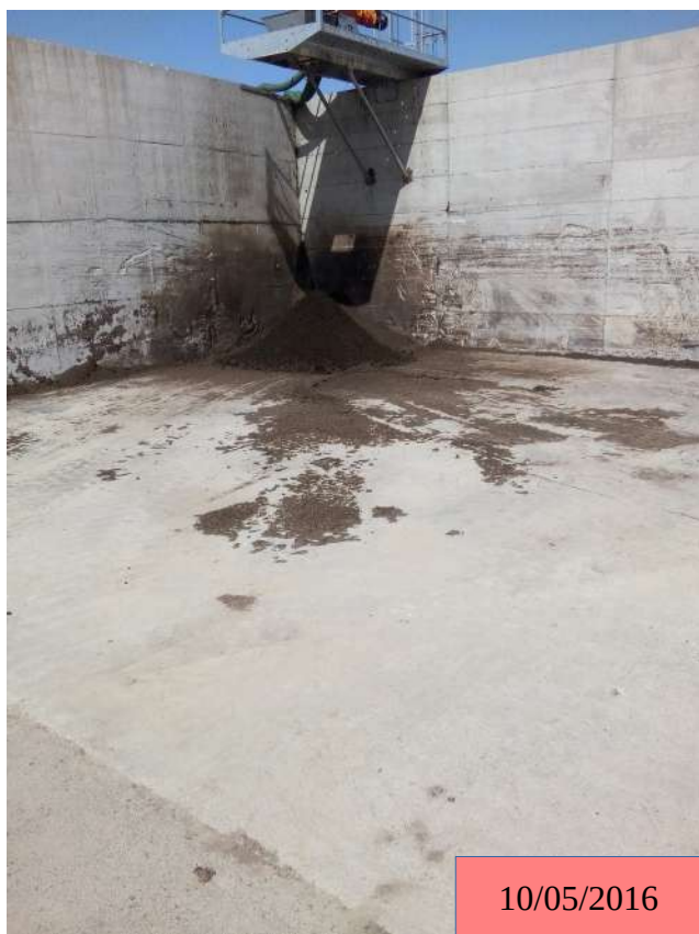
Foto n 21 – Centrifuga digestato solido senza copertura e sistema di raccolta AMDC.
